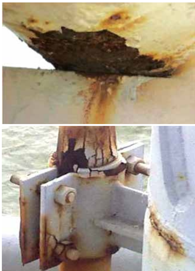
Hình 1. Hình ảnh ăn mòn đường ống tại vị trí gối đỡ.
